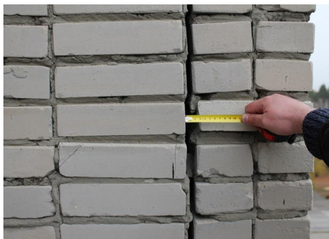
Рисунок 6 – Пример расслоения кирпичной кладки боковых стен лоджий
