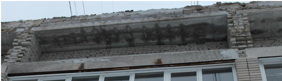
Рисунок 8 – Отсутствие анкеров и сеток в местах крепления стенового ограждения к боковым стенам и перекрытию лоджии 9-ого этажа
