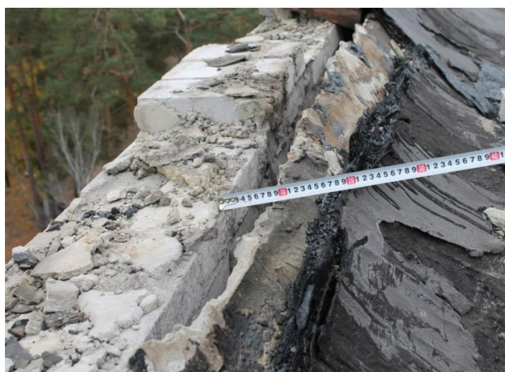
Рисунок 1 – Прогрессирующая трещина шириной раскрытия 8 см между перекрытием и наружным стеновым ограждением лоджии
