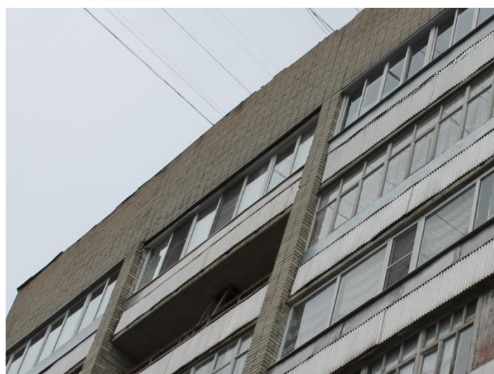
Рисунок 2 – Крен стенового ограждения лоджии 9-ого этажа
