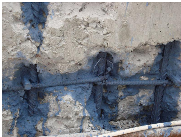
Рисунок 2 – Откол защитного слоя бетона
