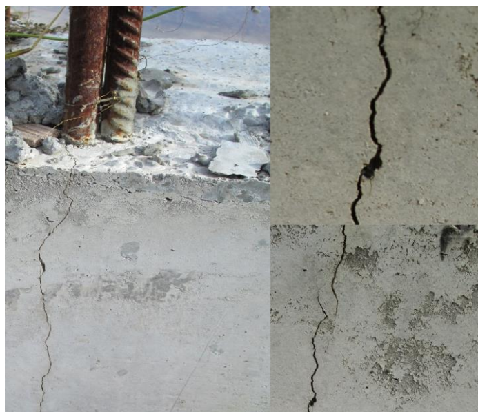
Рисунок 4 – Результаты визуальной оценки состояния: трещины в железобетонных балках пролетного строения.
