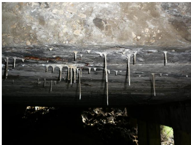
Рисунок 1 – Нарушение гидроизоляции. Выщелачивание бетона с образованием сталактитов
