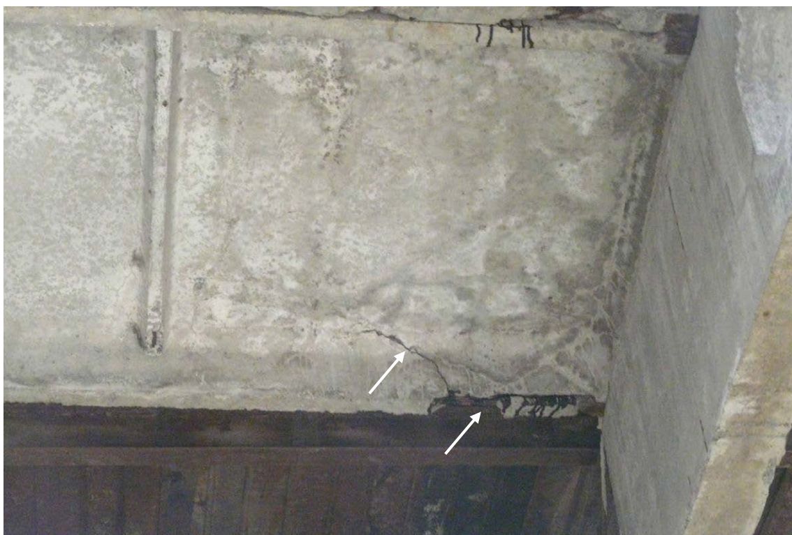
Рисунок 1 – Фрагмент требующей усиления плиты покрытия.
