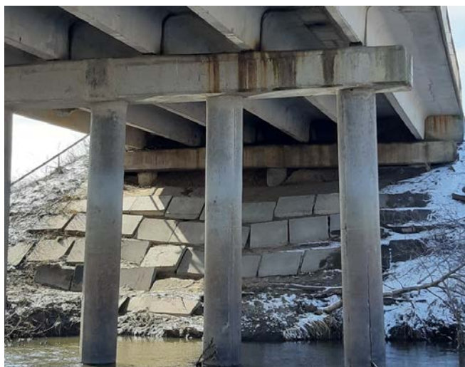
Рисунок 2 – Разрушение устоя моста
