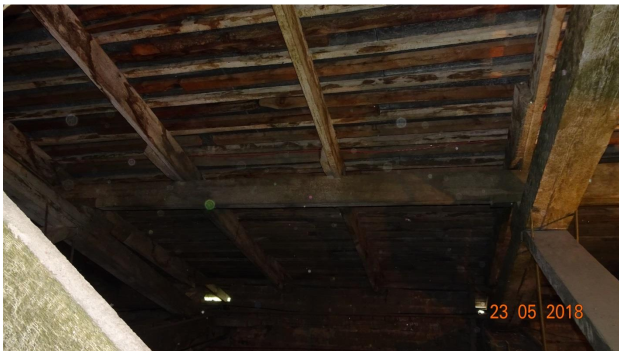
Рисунок - 7. Местное загнивание стропильных ног и обрешетки.
