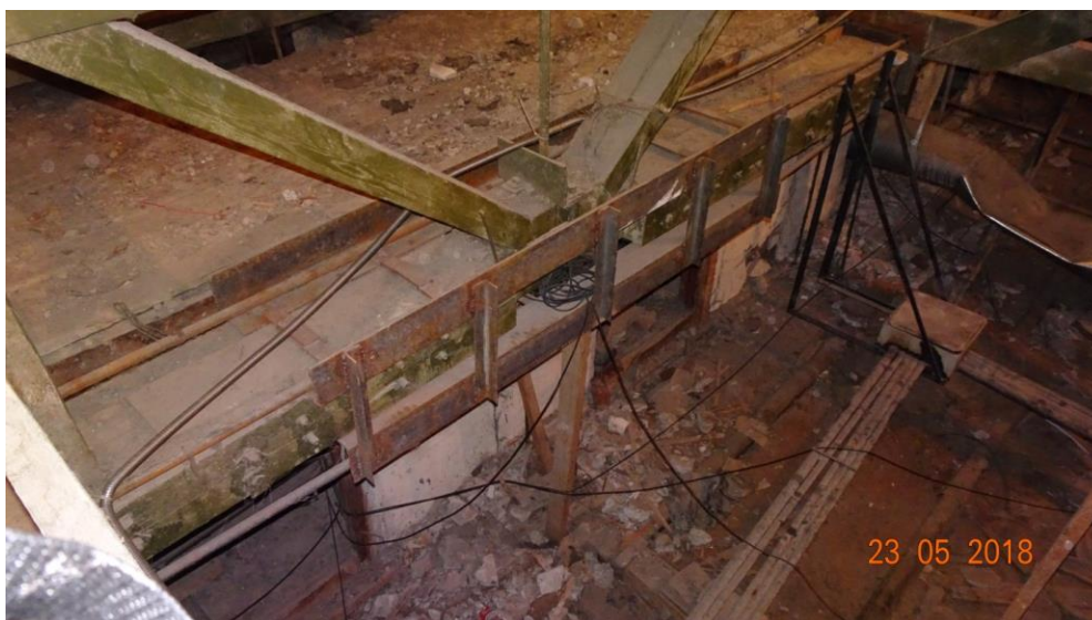
Рисунок 3 – Строительный и бытовой мусор на перекрытии
