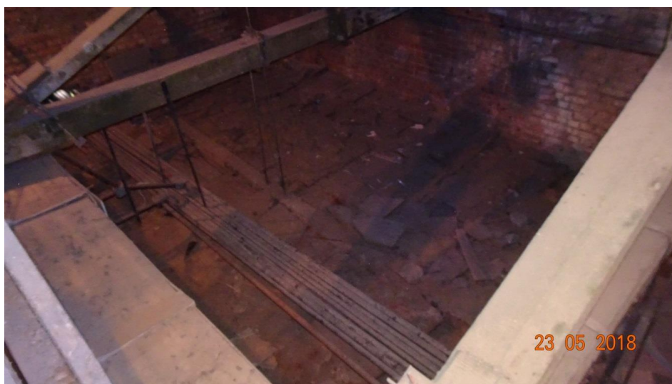
Рисунок 5 – Отсутствие дополнительного слоя утеплителя по периметру наружных стен
