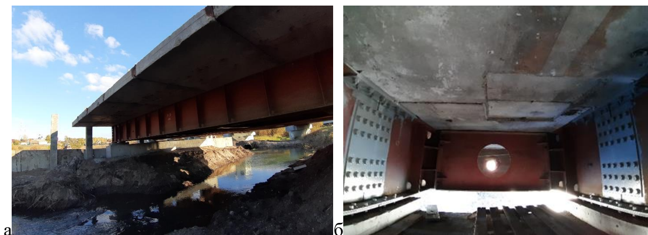
Рисунок 1 – Строительство временного моста: а – общий вид, б – мостовые инвентарные конструкции пакетные МИК-П
