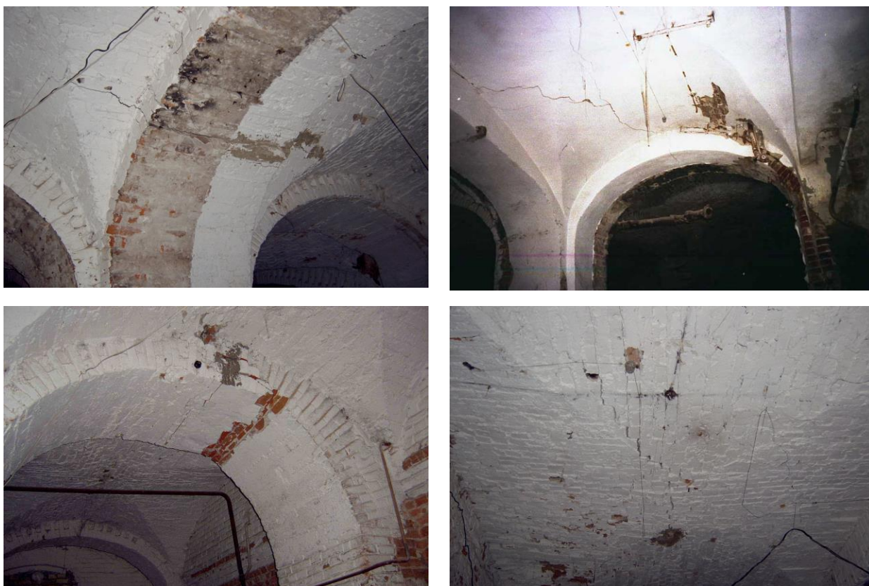
Рисунок 2 – Схемы развития (а) и общий вид трещин в сводах и арках перекрытия подвального помещения (б)
