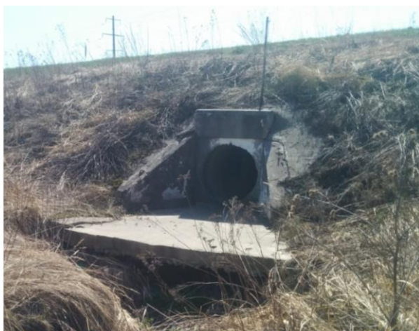
Рисунок 1 – Текущее состояние существующей трубы, оголовков и основания
