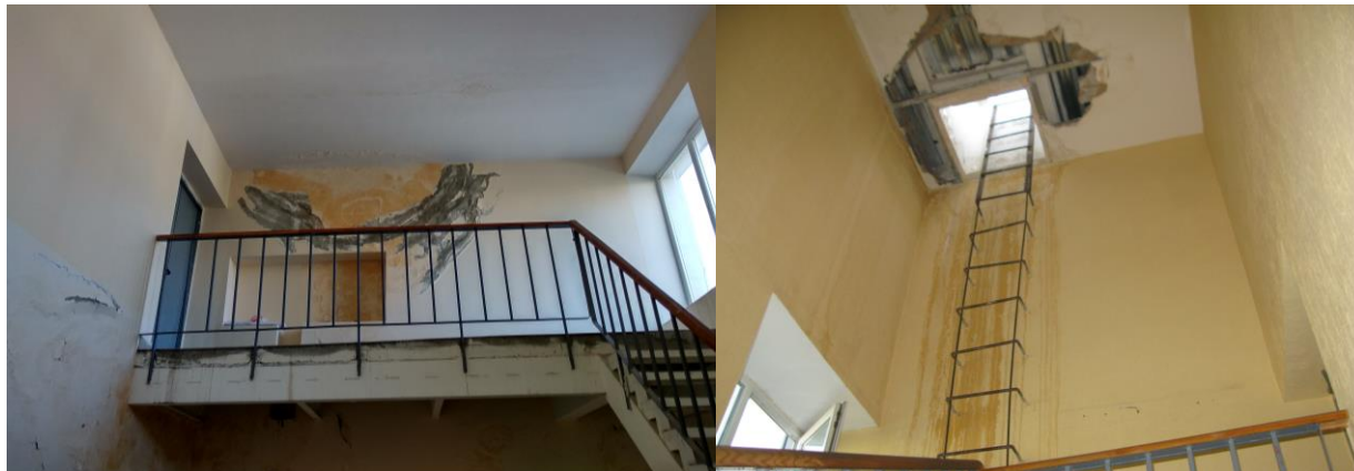
Рисунок 1 - Следы протечек мягкой кровли
