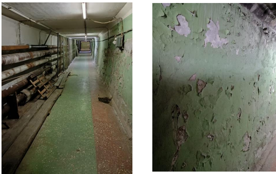
Рисунок 3 – Состояние стен перехода
