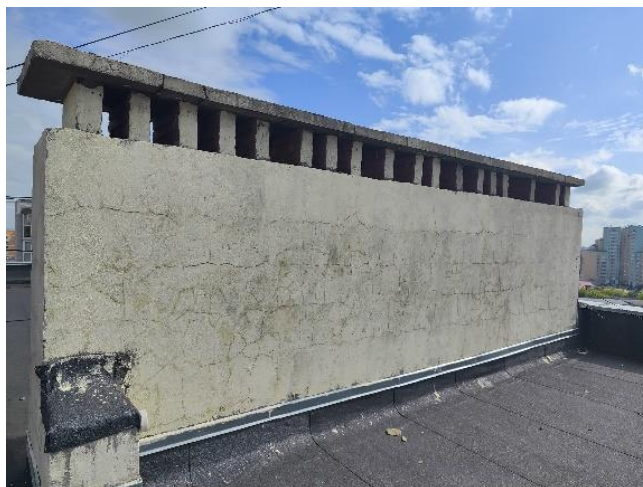
Рисунок 7 – Трещины в штукатурном слое вентиляционных шахт
