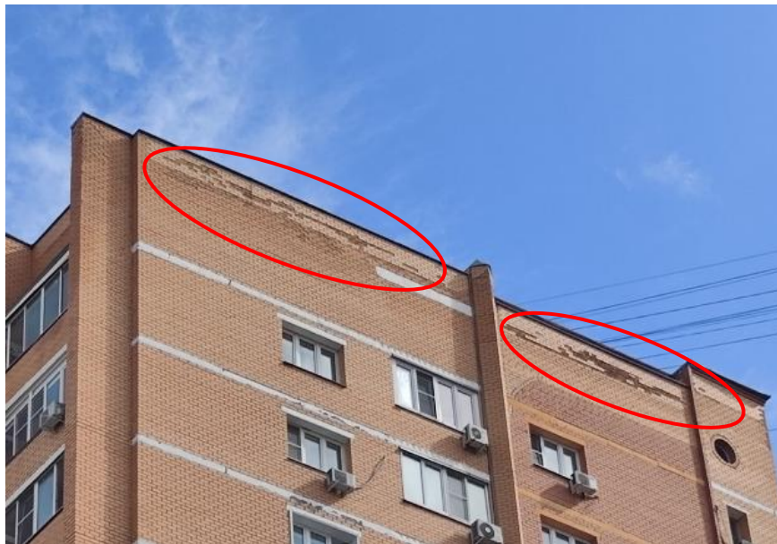
Рисунок 5 – Разрушение кирпичной кладки
