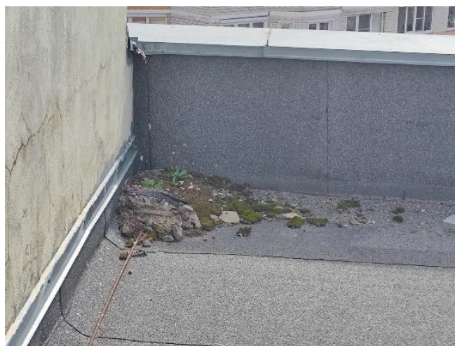
Рисунок 4 – Наличие строительного мусора, расположенного на рулонном кровельном покрытии
