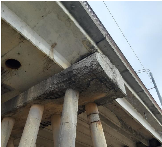
Рисунок 1 – Разрушение несущих конструкций Сурского моста, г. Пенза
