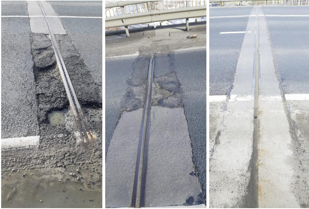
Рисунок 2 – Дефекты деформационного шва
