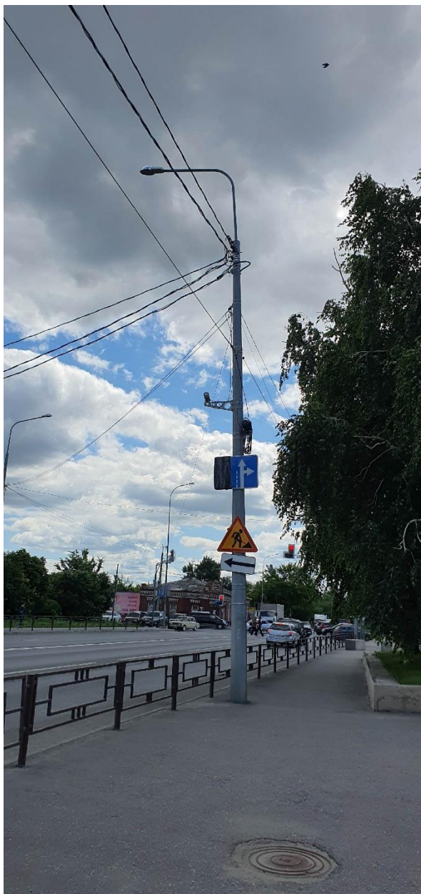
Рисунок 1 - Опоры линий электропередач
